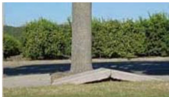
Imag. 4.13 Banquetas deterioradas por raíces de árboles
