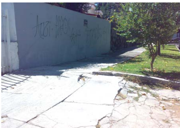
Imag. 4.11 y 4.12 Diversas formas de deterioro en banquetas causadas por la vegetación
