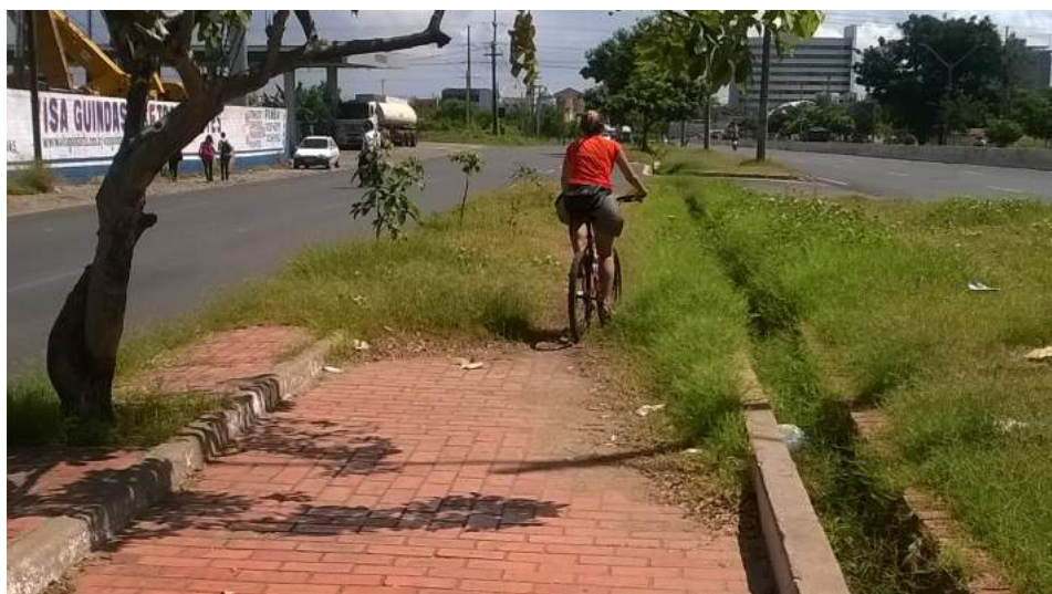
Foto 59: Cabeceira de ciclovia mal finalizada, na Av. Pref. Wall Ferraz Fonte: TC Urbes, 2015
