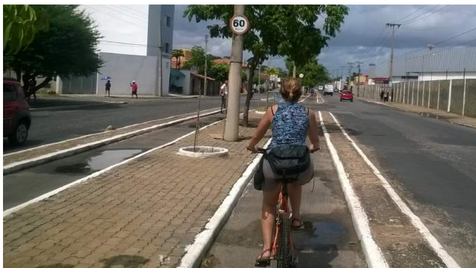
Foto 58: Sistema de drenagem falho deixa poças e compromete a qualidade da pavimentação, na Av. Duque de Caxias Fonte: TC Urbes, 2015
