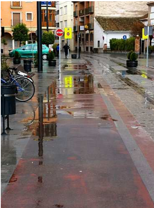
Drenaje mal concebido: la vía ciclista parece incluso acumular agua del entorno
